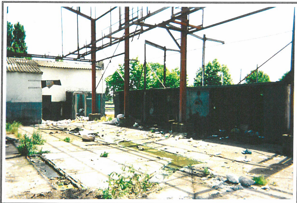
Photo 3 : Ancien abris des pompes à vapeur de l'aire de lavage des citernes
