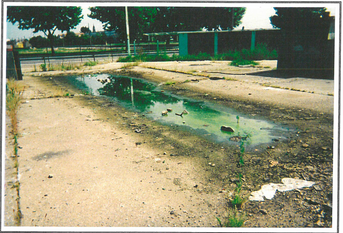
Photo 5 : Aire de lavage recouverte d'une importante flaque d'eau
