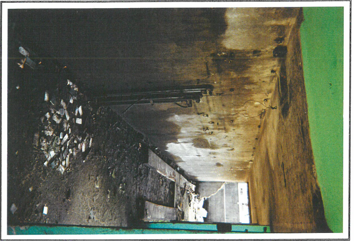
Photo 9 : Canalisations de la centrale de graissage
